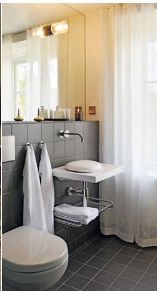
Badrummen är byggda på ett sätt som gör att de kan lyftas bort.
