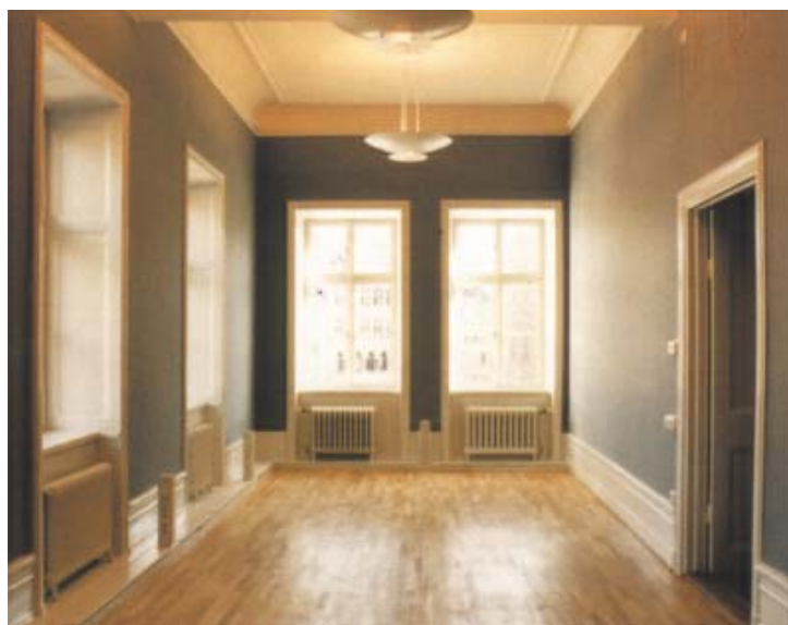
Alla installationer – el, tele, data och värme – löper lättåtkomligt i den låga sockellådan invid väggen. Då renoveringen är avslutad kommer fastigheten att rymma cirka 400 kontorsarbetsplatser.
