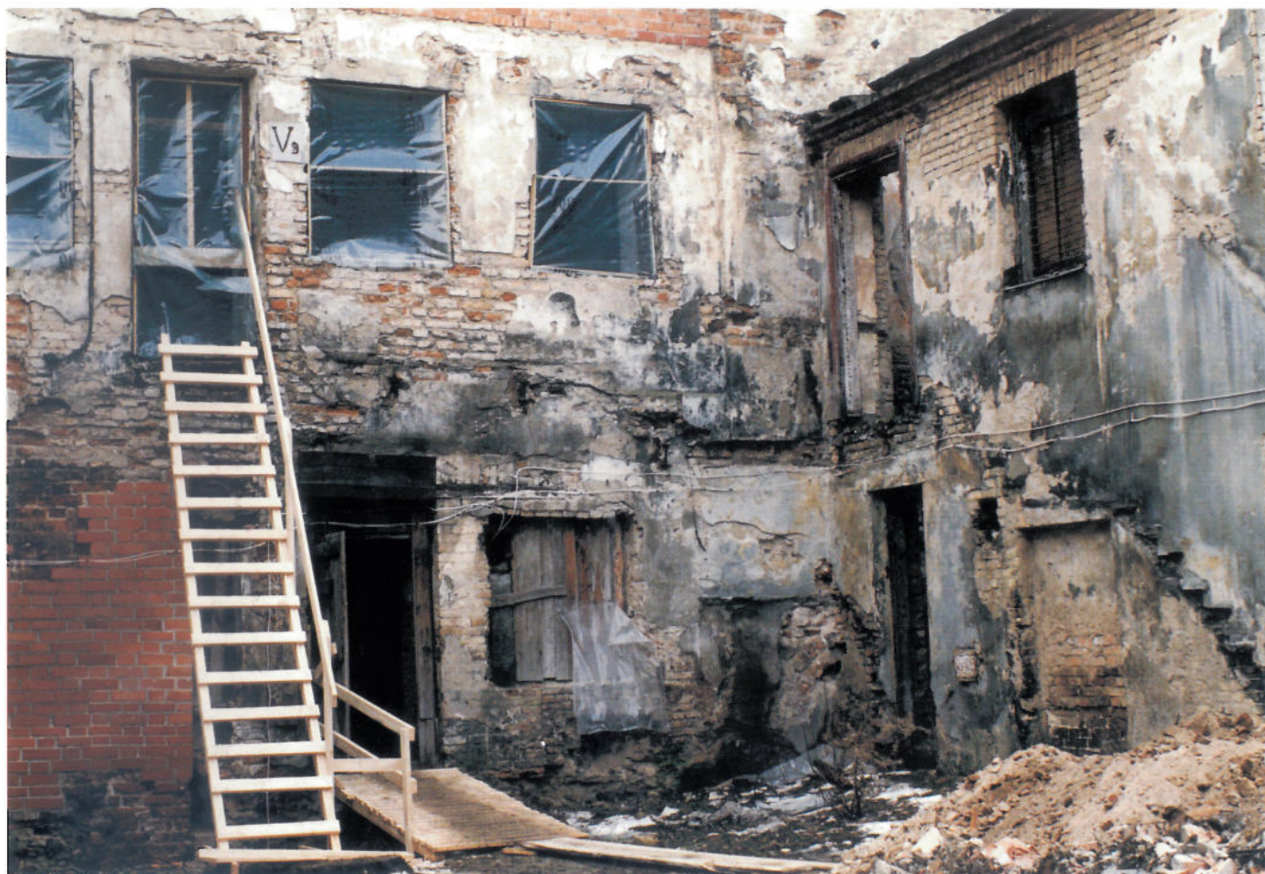
Byggnaden är förfallen och måste totalrenoveras.
