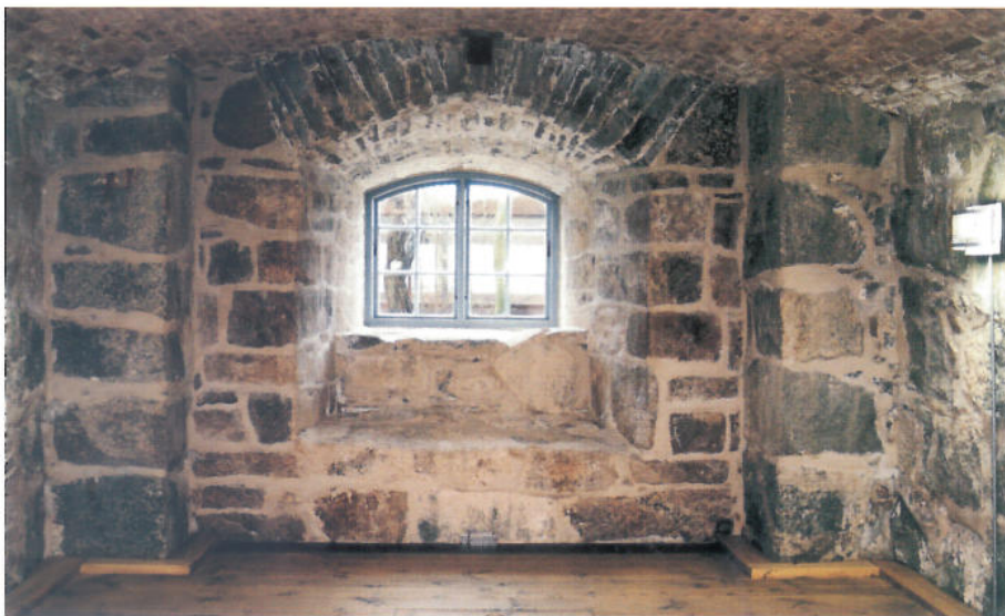
Ett nypupptaget fönster i norra krutmagasinet. Brädgolvet är nylagt och varm luft förs in i rummet från ett enkelt värmeaggregat via springan längs väggen.
